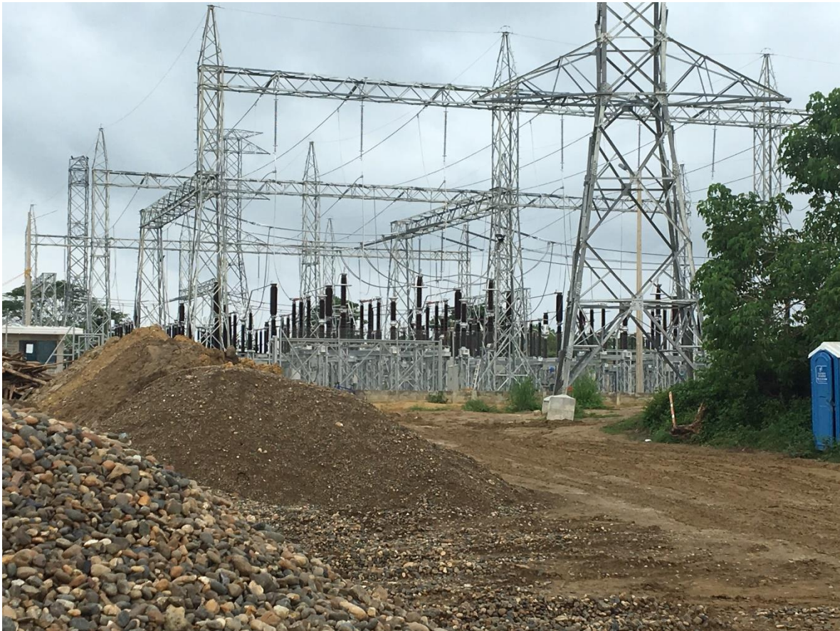
Subestación Caracolí 220 KV.
